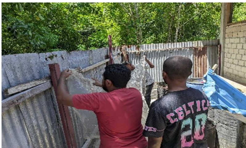
Gambar 2. Pengadaan Pipa, Mesin Pompa dan Instalasi Pompa Serta Pipa Aerasi
